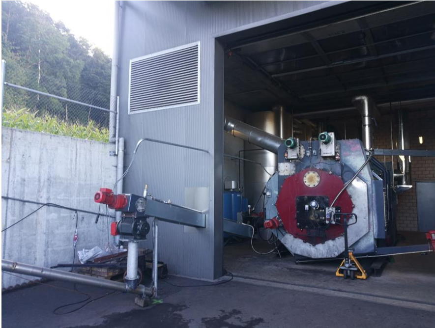
Pflanzkohle-Pyrolyseanlage in Flaach
